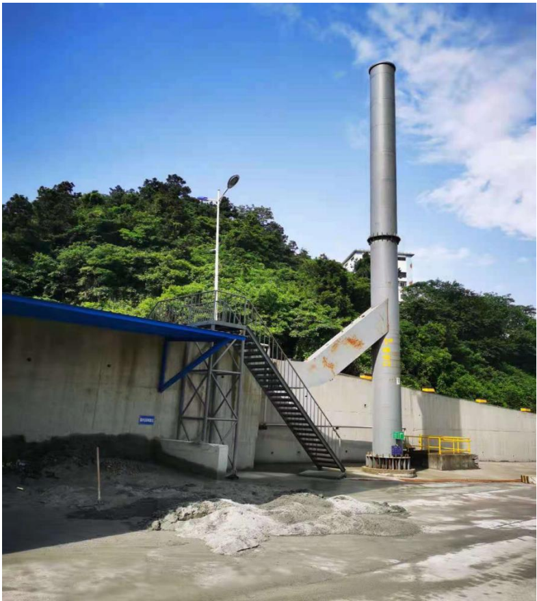
1#布袋除尘器配套的P1排气筒
