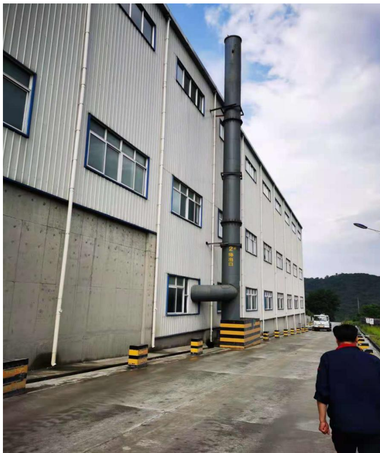
2#布袋除尘器配套的P2排气筒
