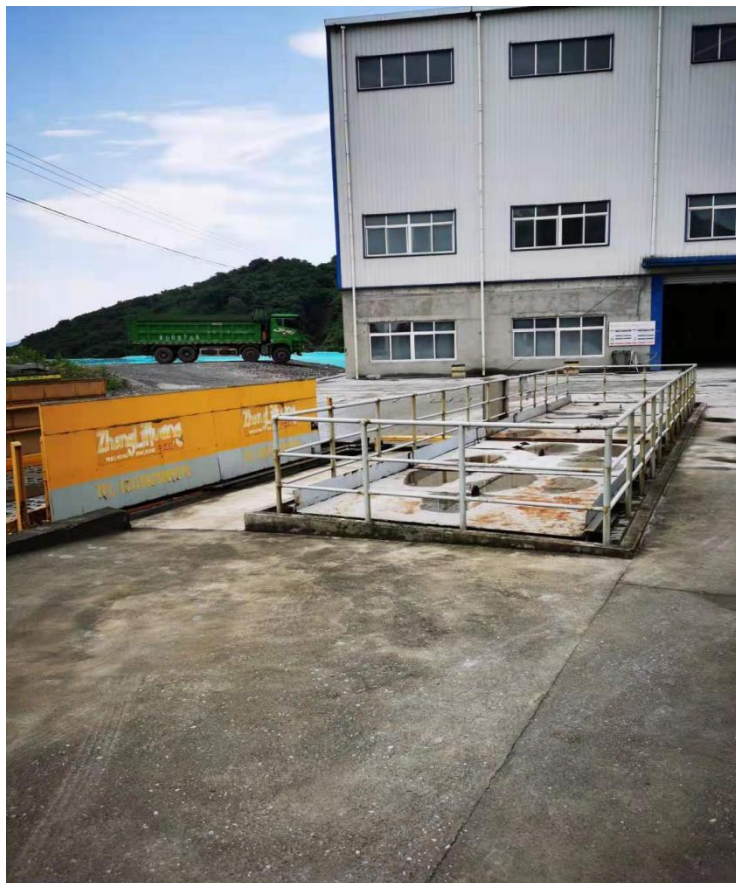
生活污水地埋式处理设施
