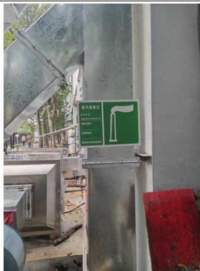
废气排放口标识牌
